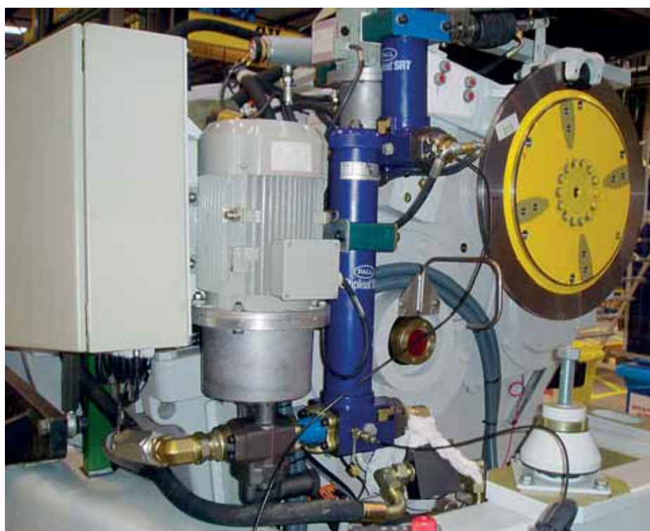
Pall Ultipleat® SRT -suodattimet tuulivoimalan vaihteessa.
